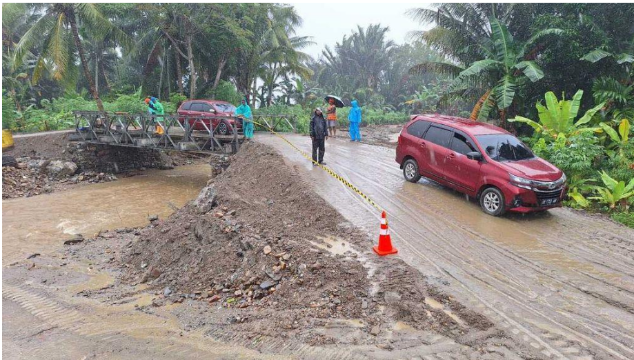
Gambar 11. Kondisi Jalan yang Buruk Akibat Cuaca Ekstrem
